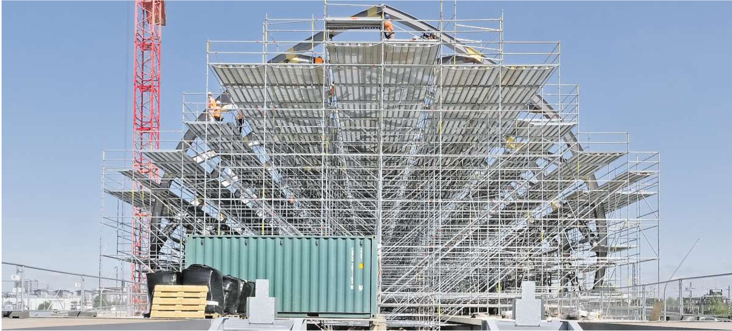
Die U-Bahnhaltestelle Elbbrücken wird ein Schmuckstück. Derzeit läuft die Installation der Scheiben für das Glasdach auf Hochtouren. Dezember 2018 sollen die Bauarbeiten abgeschlossen sein
